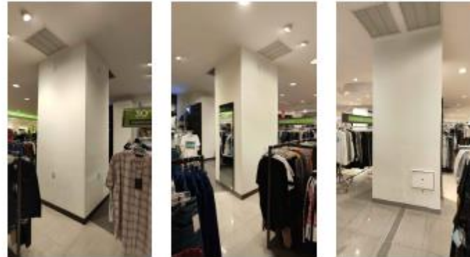
COLUMNA. ESTADO ACTUAL.
