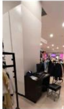
ESTADO ACTUAL COLUMNA
