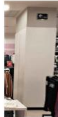
ESTADO ACTUAL COLUMNA
