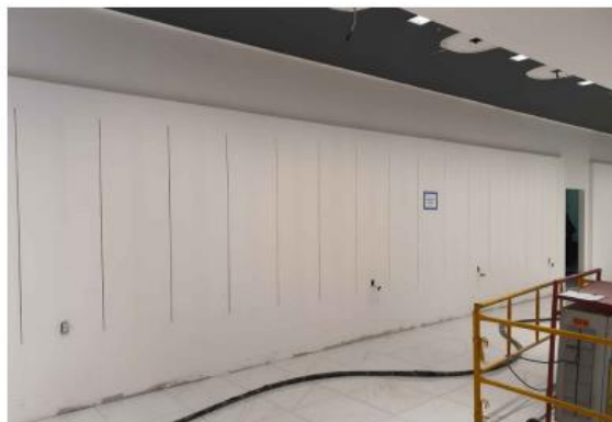
SE PUEDE APRECIAR QUE EL PERIMETRO ASIGNADO CUENTA CON SALIDAS ELECTRICAS PARA CONTACTOS
