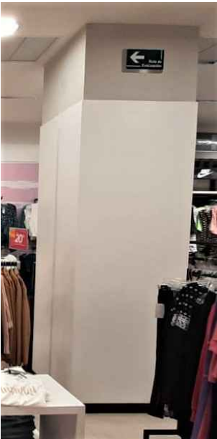
ESTADO ACTUAL COLUMNA
