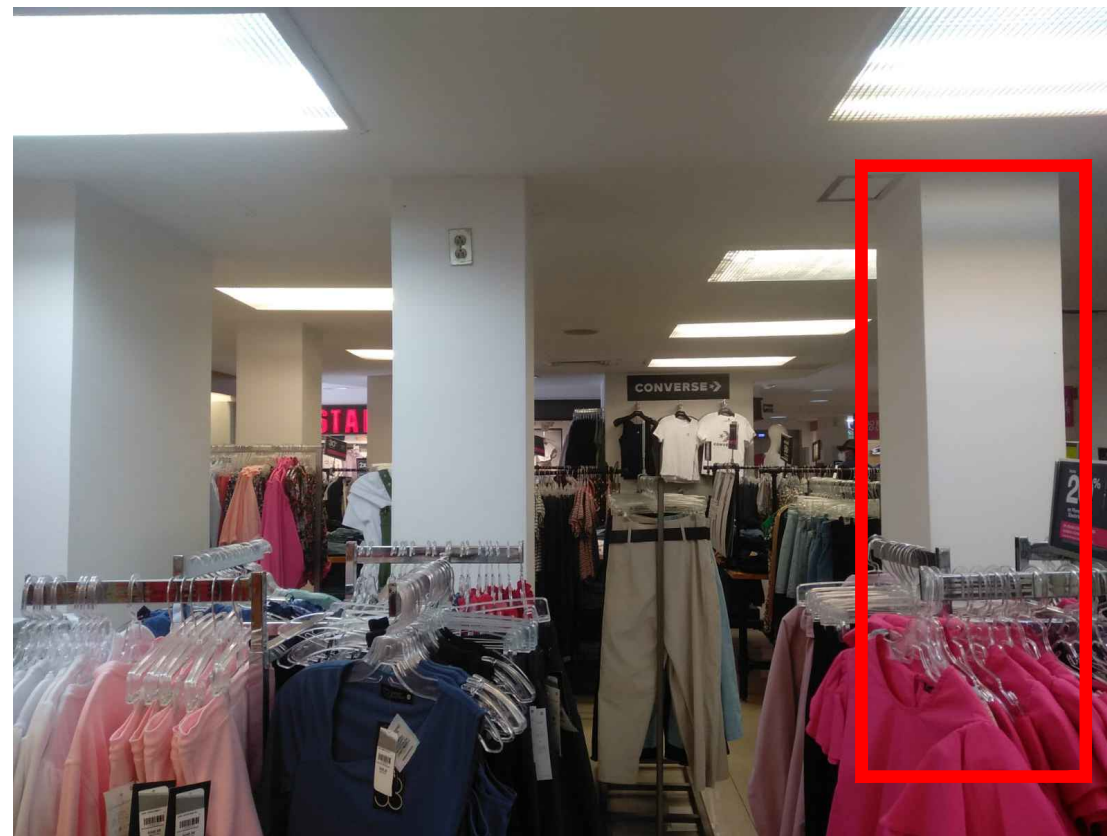
COLUMNA. ESTADO ACTUAL
