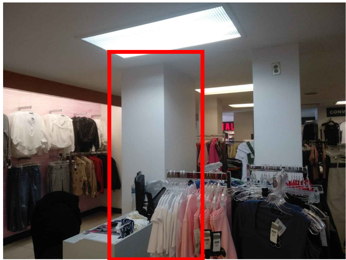
COLUMNA. ESTADO ACTUAL
